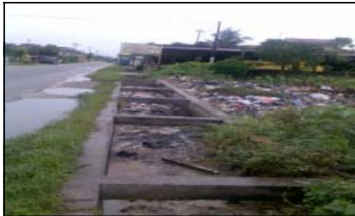
Gambar 2.5 Saluran Drainase yang Dipenuhi Sampah dan Endapan Lumpur
